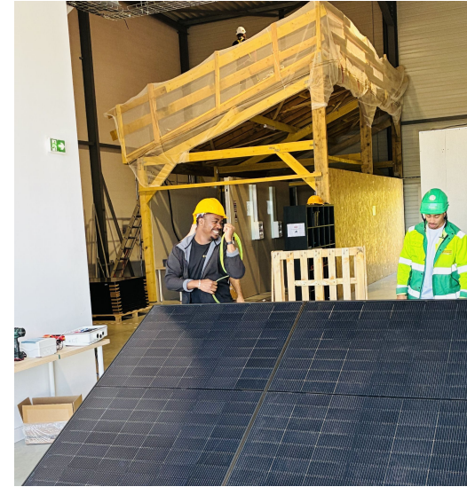
Plateaux techniques PV et IRVE
